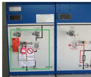
Consignación del selector en posición neutra, dejando las dos mirillas ocultas. Selector in neutral position, locked and tagged-out, covering the two selector ports.
