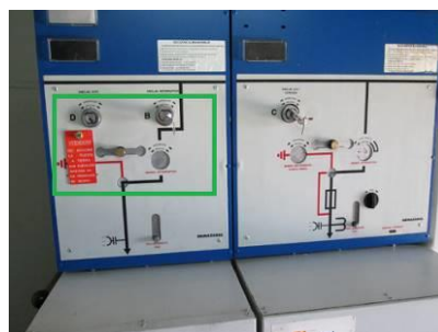
Resaltado arriba, el sinóptico de la celda de línea. Above, the line switchgear panel synoptic outlines.
