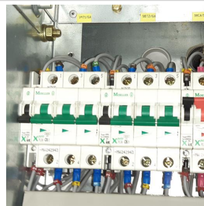
98T1 y 98T2 abiertos seccionando la alimentación de los secundarios del transformador de tensión 98T1 and 98T2 open, disconnecting the power supply of the voltage transformer secondaries
