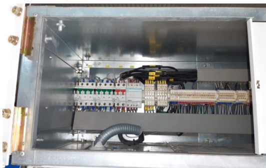
Habitáculo de control de la celda Switch control box
