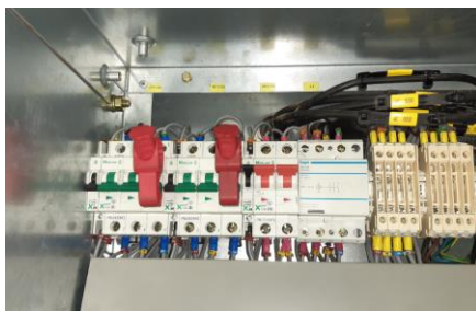
Bloqueo instalado en ambos dispositivos Lock installed on both devices
